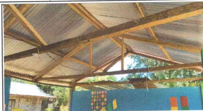
Foto 2: Se evidencia la estructura de madera a remozar.
